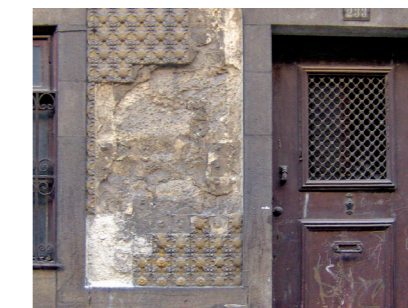
08 | Degradação de argamassas
