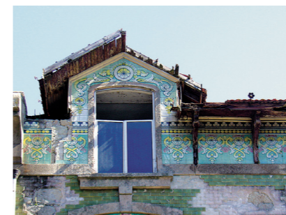
09 | Abandono e negligência
